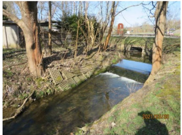
Sohlstufe Köstitz 4 vor Maßnahmenumsetzung (März 2021)
